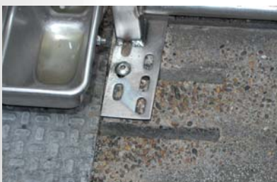
Eksempel på tæring af spaltegulvet i en sti behandlet med et imprægneringsprodukt
